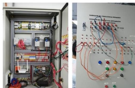
Figura 9. Tablero de control
